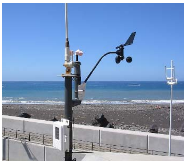
Figura 14 .- Aneómetro Davis instalado en la Capitanía del Puerto de Tazacorte
