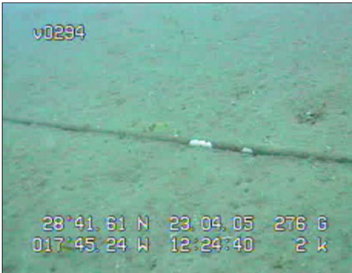
Figura 2.- Cable telefónico Telapa
