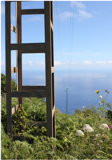
Imagen 22. Vista del tendido eléctrico en la zona alta del PP del Tablado. Fuente: elaboración propia.
