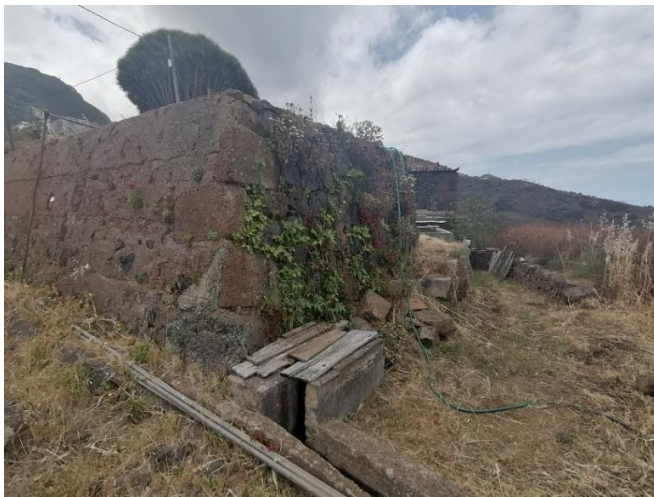
Imagen 34. Estanque de mampostería tradicional y atarjea para riego por gravedad. Fuente: Elaboración propia.
