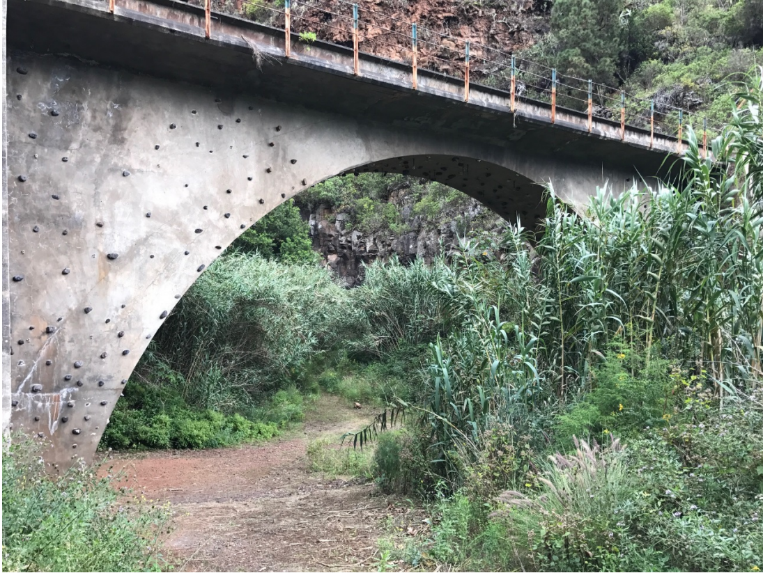
Detalle del primer punto de escalada (antiguo puente) donde se puede observar el intenso poblamiento de Arundo donax y otras invasoras como Pennisetum setaceum .
